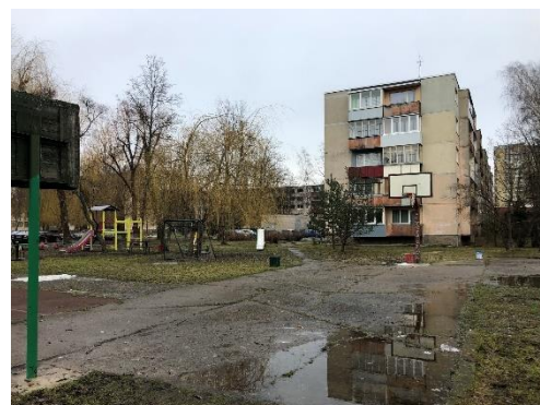
168 pav. Susidėvėjusios dangos ir drėgmės susikaupimas paviršiuje
