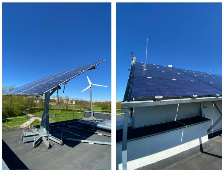
5 pav. KTU laboratorijos, esančios Studentų g. 48A, stogas su 3 kW pasukama ir 3 kW stacionaria saulės elektrine, sudarytą iš 24 vnt. Solitek” įmonės G/G 240-250 modelio modulių bei Sunny Tripower 6000TL-20 ir GCI-5K-H inverterių [ 28]
