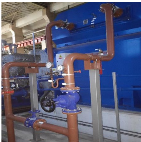
4 pav. Turbinos generatoriaus oro aušintuvas
