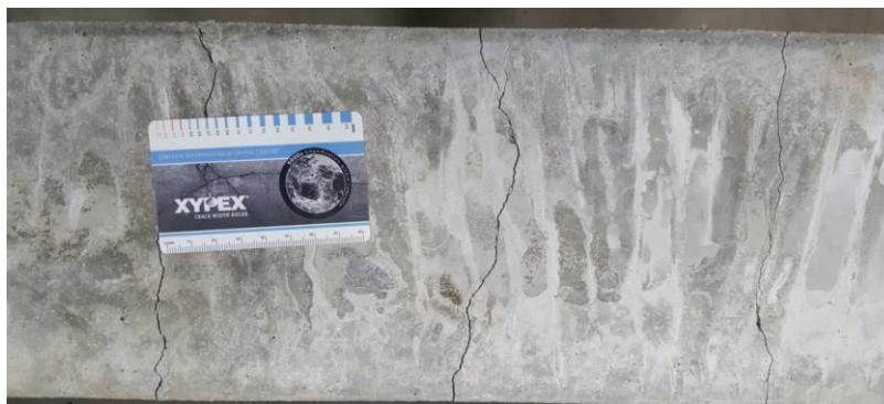
2.4 pav. Gelžbetoninės sijos normaliniai plyšiai tempiamoje zonoje
