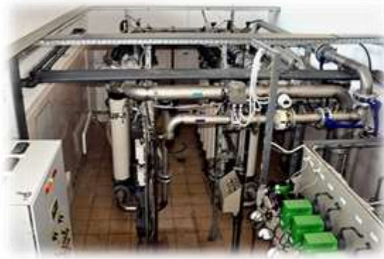
4 pav. Ultrafiltracijos proceso įrenginys [1]
