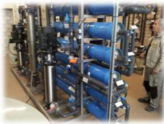
5 pav. Atvirkštinės osmozės įrenginys UAB „Utenos šilumos tinklai“[2]
