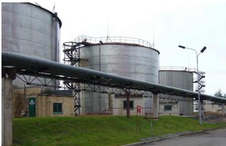
5.3 pav. Mazuto rezervuaro talpos.
