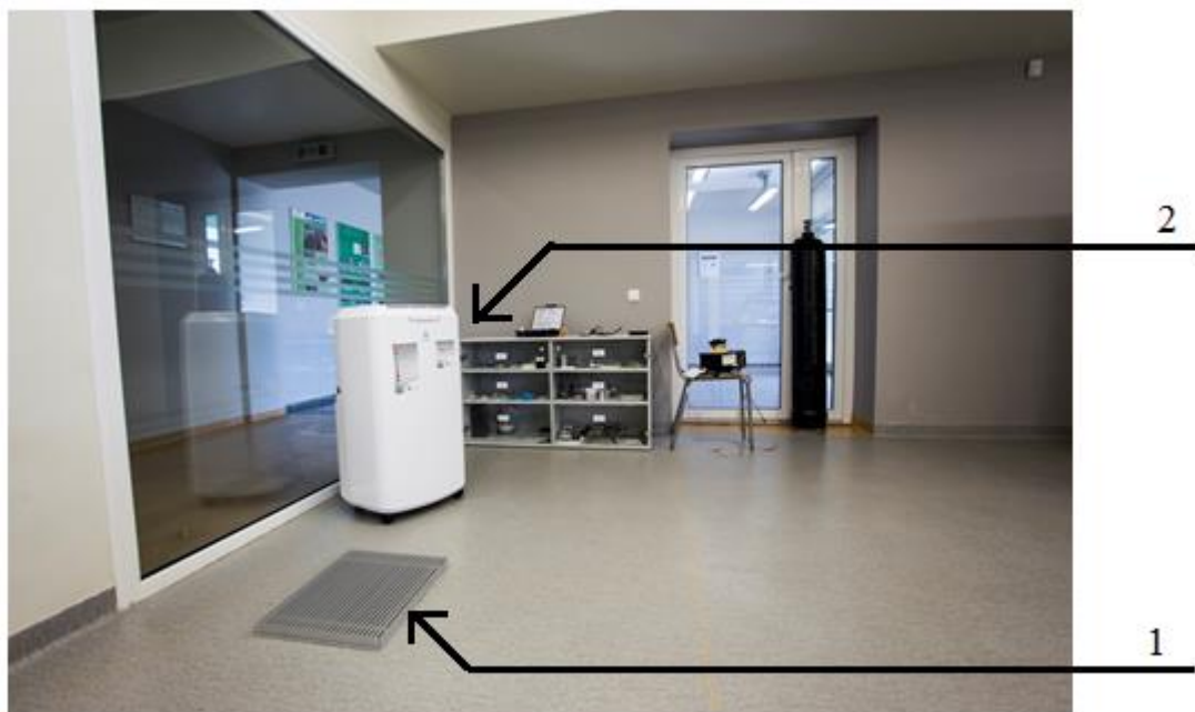
10 pav. Mikroskopijos patalpa. 1 – oro ištraukimo grotelės, 2 – mobilus oro kondicionierius
