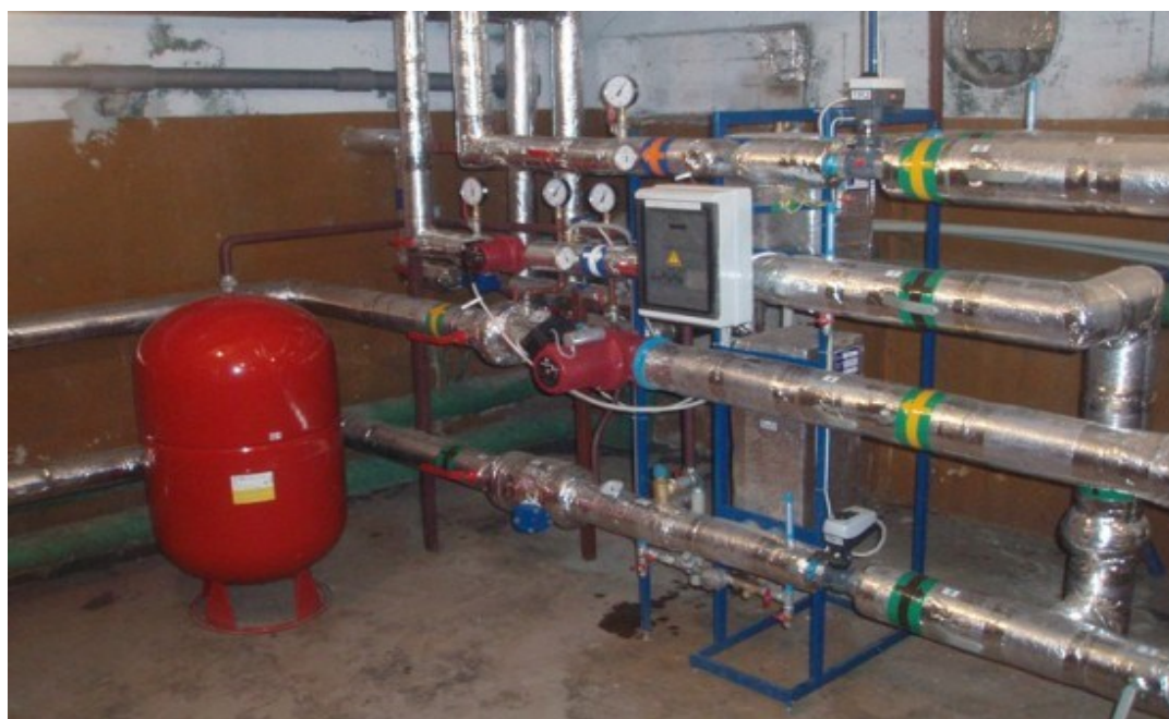
2 pav. Modernizuotas šilumos punktas
