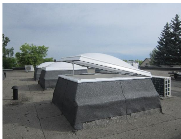
38 pav. Stoglangis su vėdinimo pavara. Vaizdas iš išorės (asmeninis archyvas).
