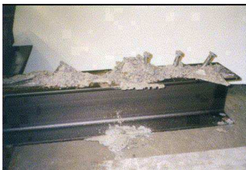
8 pav. Betono kūgio suirimas [8]
