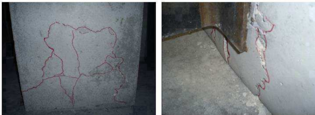
22 pav. Betono suirimas: kairėje – viršutinėje plokštės dalyje, dešinėje – apatinėje [11]
