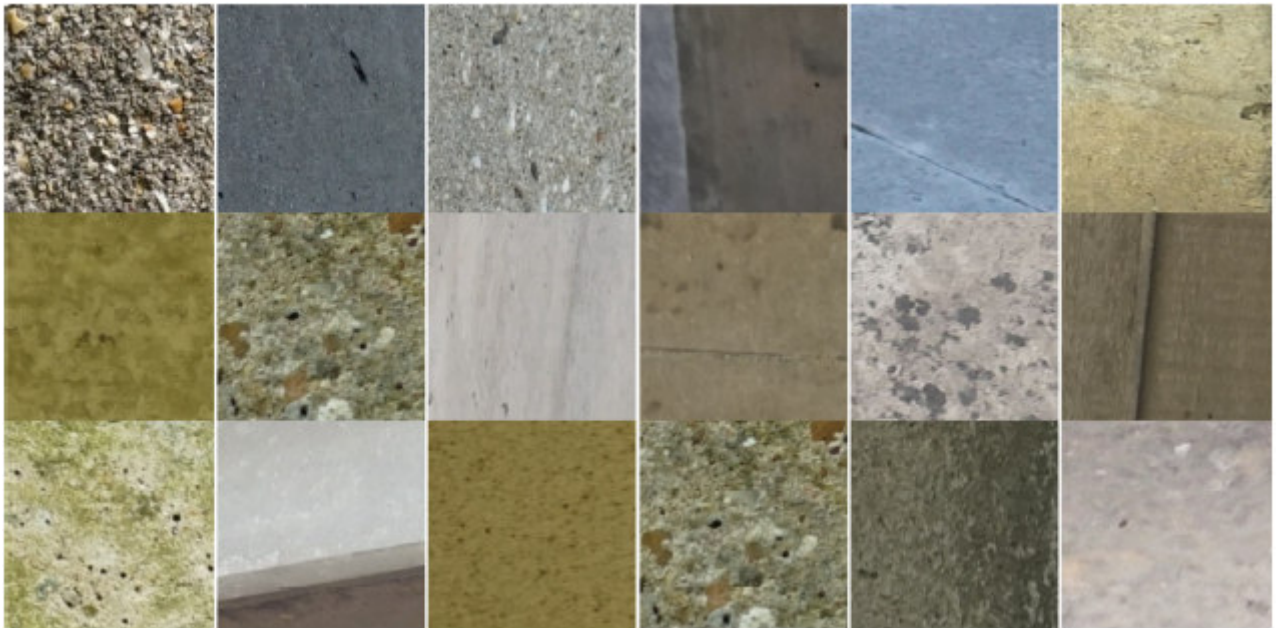
18 pav. Įrengtų betono paviršių defektai [35]
