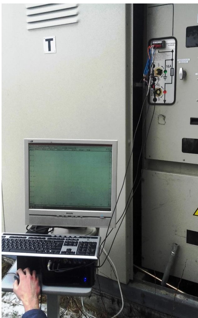
26 pav. Transformatorinėje MT M-633 prijungtas viršįtampių registratorius
