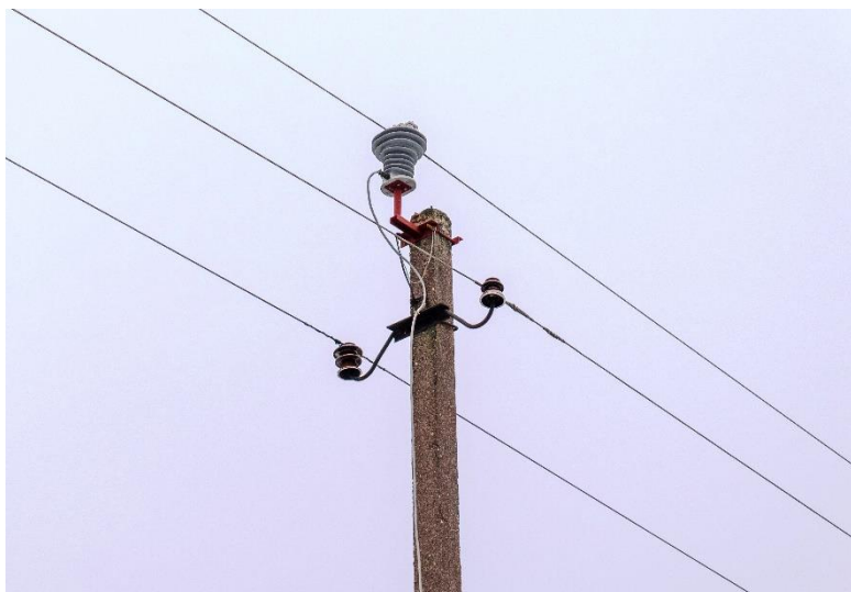
25 pav. Molėtų linijos 600/14 atramoje prie vidurinio laido prijungtas specialus srovės ir įtampos matavimo transformatorius
