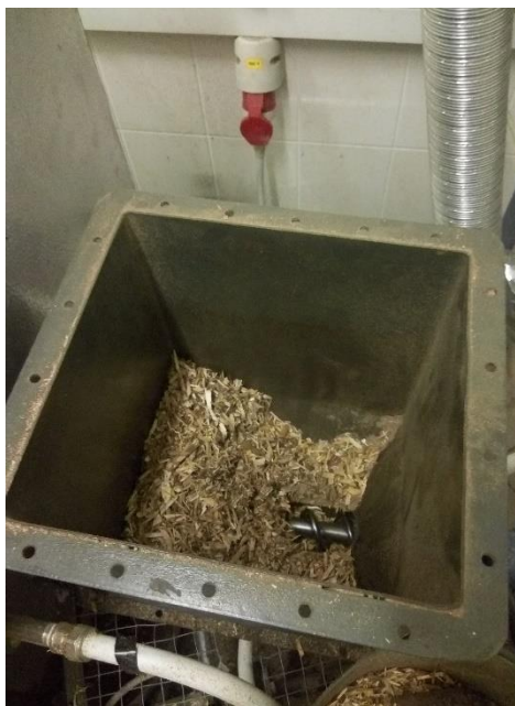
2.3 pav. Kuro bunkeris su padavimo sraigtu (proceso metu)
