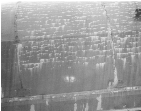
7.4 pav. Kruonio hidroakumuliacinės elektrinės vamzdžio gelžbetoninės sienos betono irimas (fotografuota 1999 m.)
