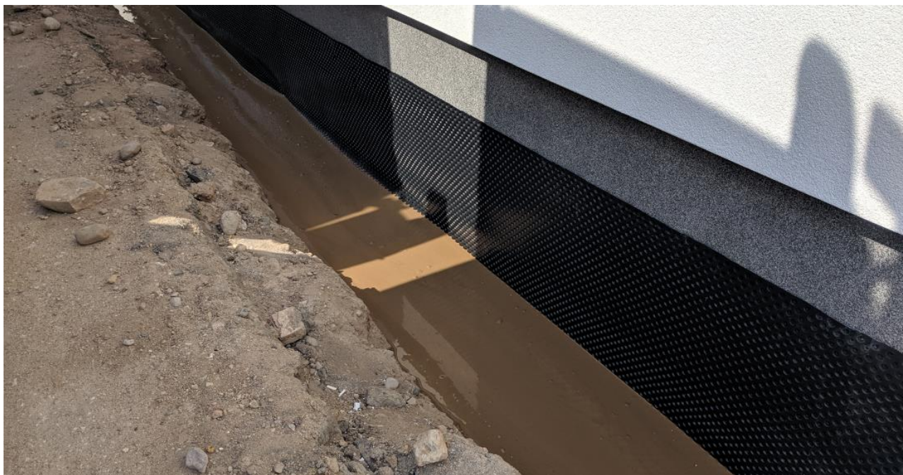
1 pav. Kauno Technologijos Universiteto Statybos ir Architektūros fakulteto pamato hidroizoliacijos darbai naudojant SSG
