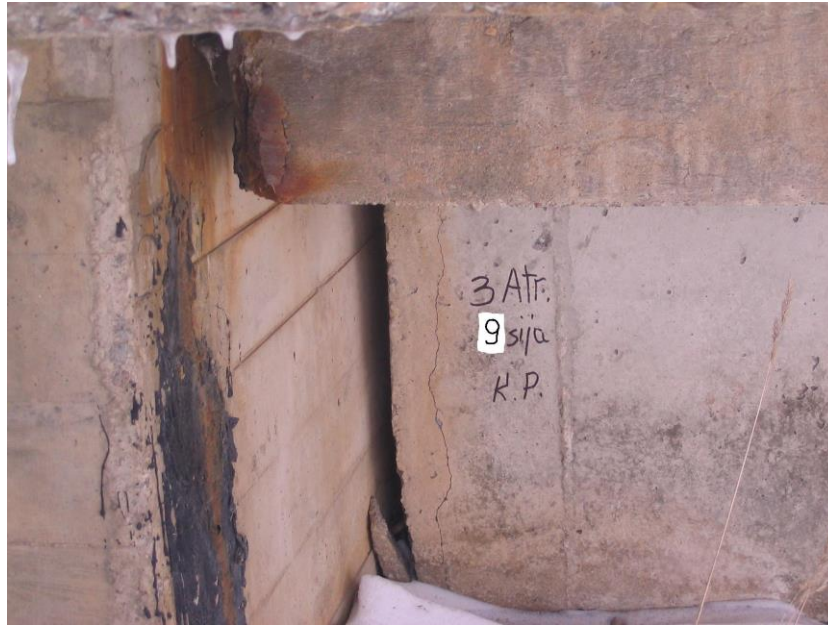
4 pav. Nesandariaus deformacinio pjūvio pasėkmė – suardytos žemiau jo esančios konstrukcijos
