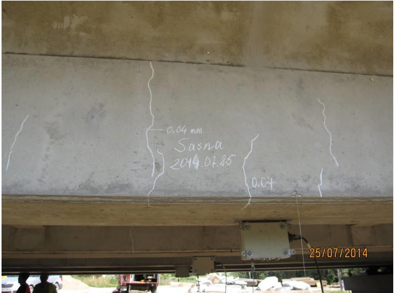
11 pav. Supleišėjusi gelžbetoninė tilto sija
