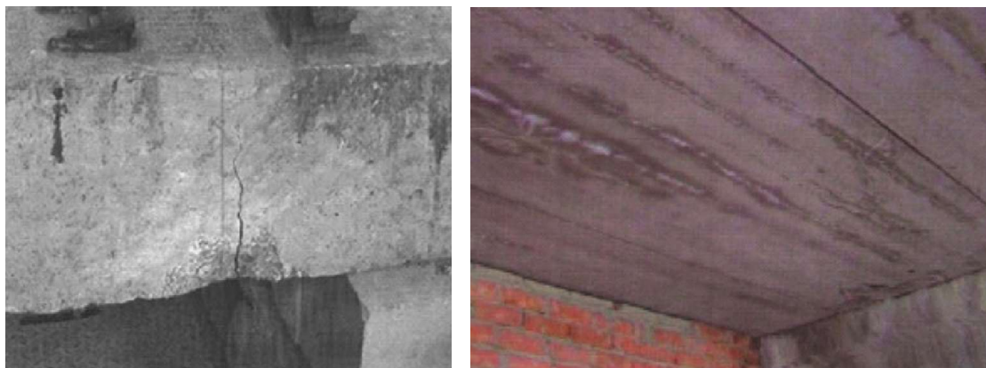
1 pav. Defektai ir pažaidos gelžbetoniniuose elementuose [6]
