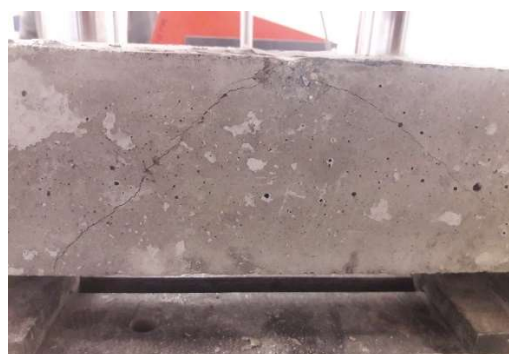
38 pav. Įstrižieji plyšiai prizmėse
