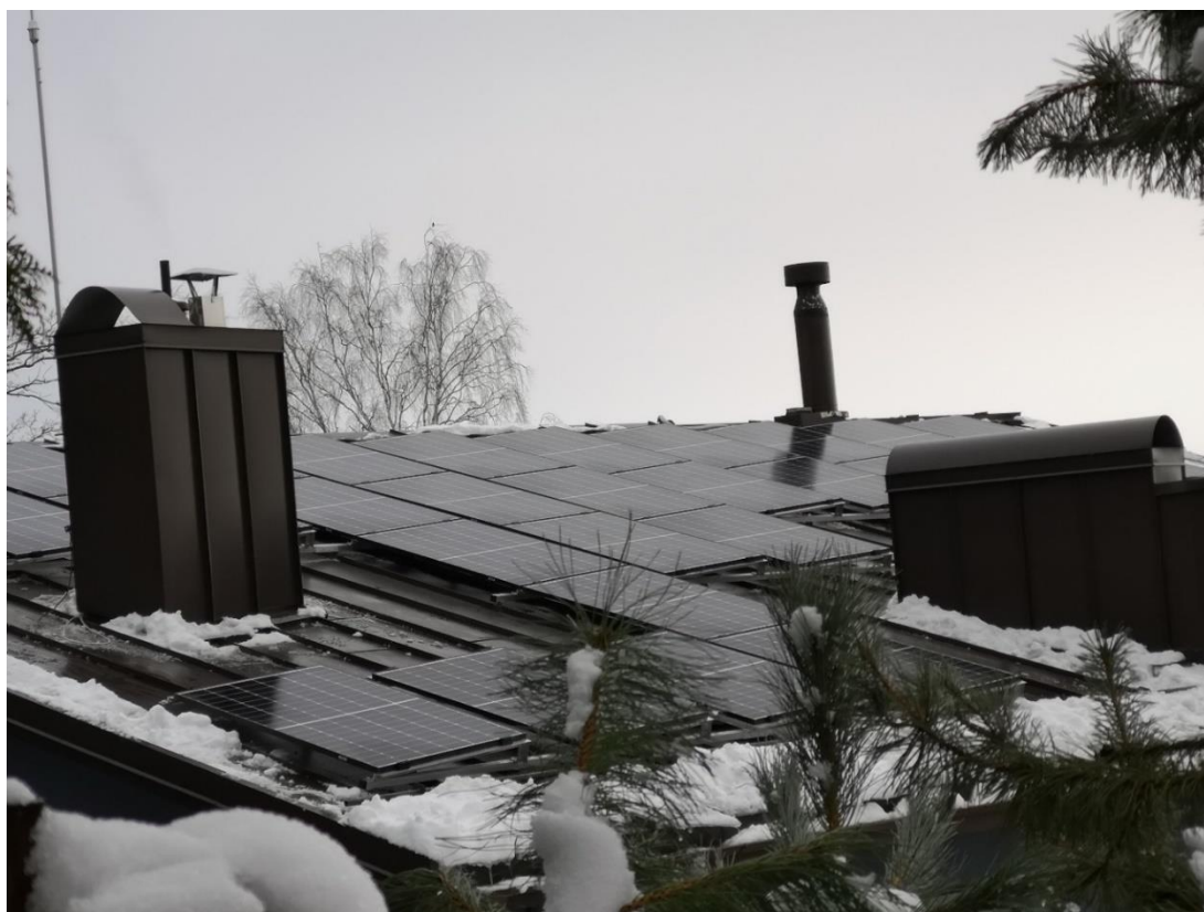
2.2.1.1. pav. Tiriamaoji saulės elektrinė
