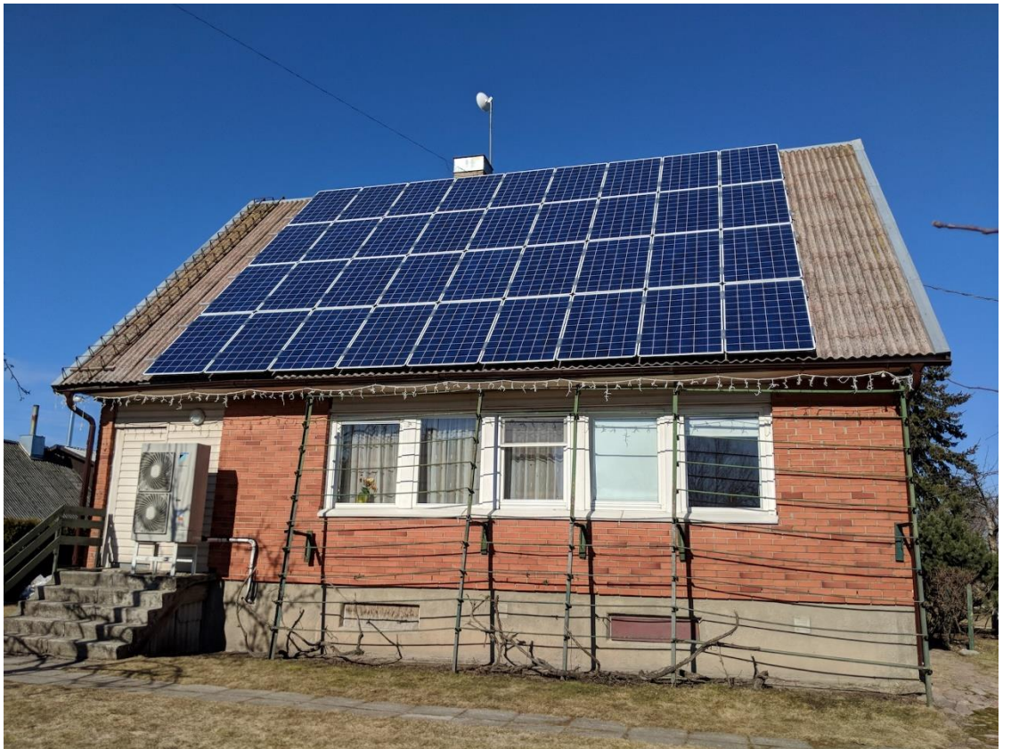
2.1.2.1. pav. Antroji tiramoji saulės elektrinė
