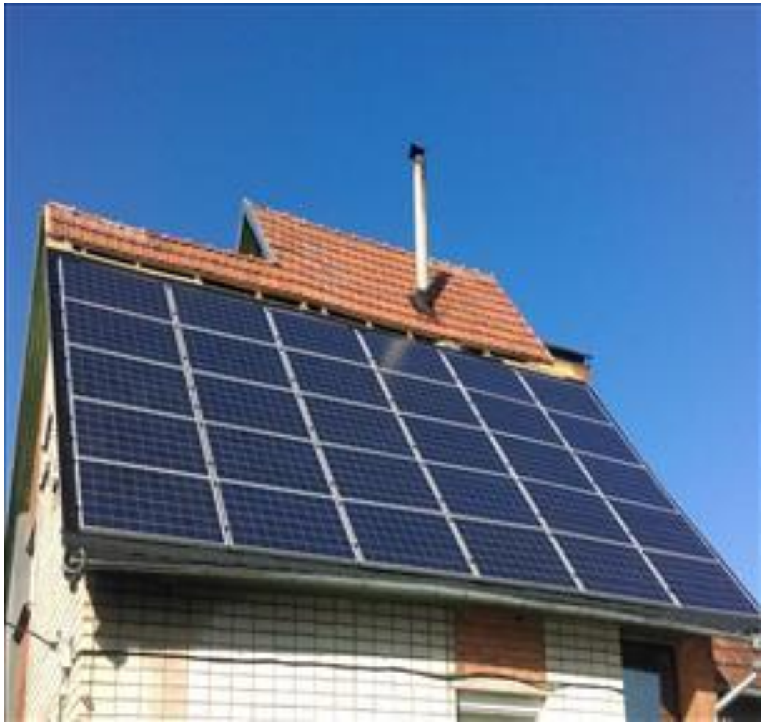
2.1.1.1. pav. Pirmoji tiramoji saulės elektrinė.
