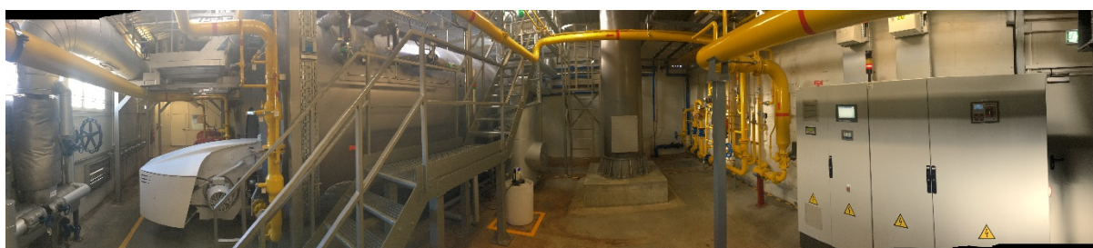
1.2 pav. UAB „Plungės kooperatinė prekyba“ garą gaminanti dujinė katilinė
