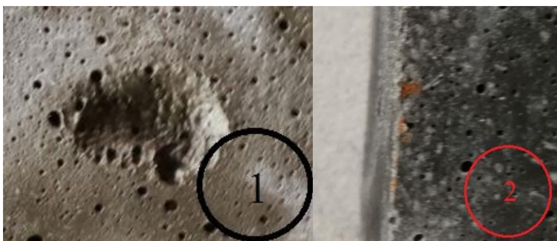
3.9.3. pav. Betono su metalo atliekomis defektai,(1)- tuštumų atsiradimai, (2)-paviršinė betono korozija
