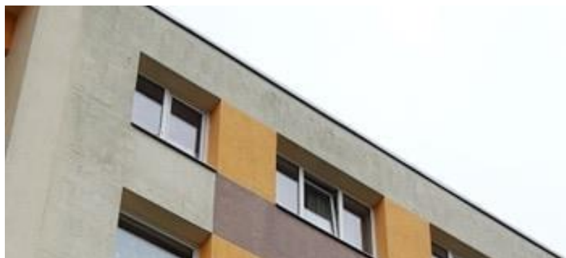
2.11 pav. Pastato parapetas paveiktas mikroorganizmų
