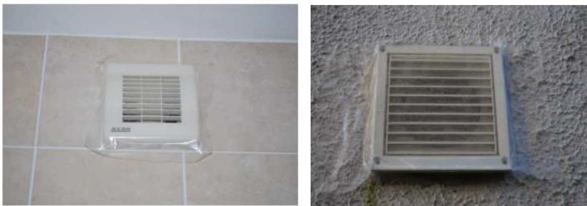
3.20 pav. Plėvele užsandarintas virtuvės vėdinimo kanalas.
