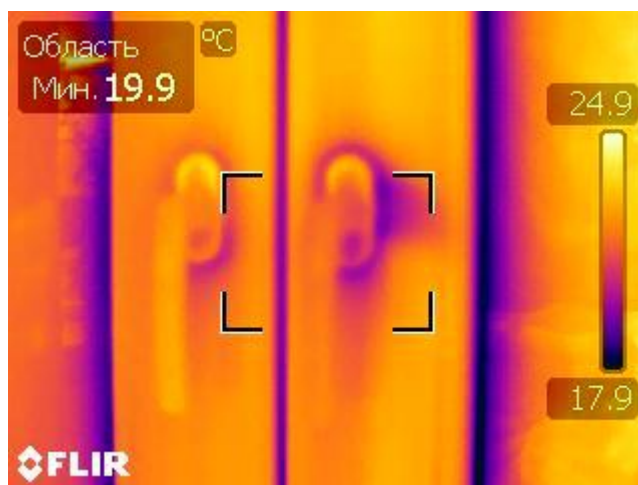
3.3 pav. Langų ir durų rankenų termografija
