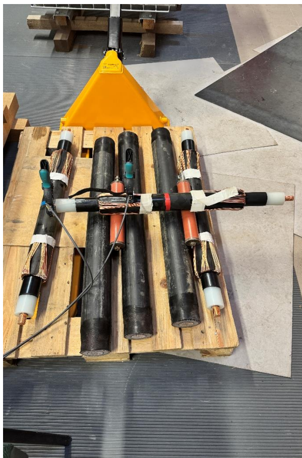
10 pav. Tiriamųjų kabelių segmentų bendras vaizdas
