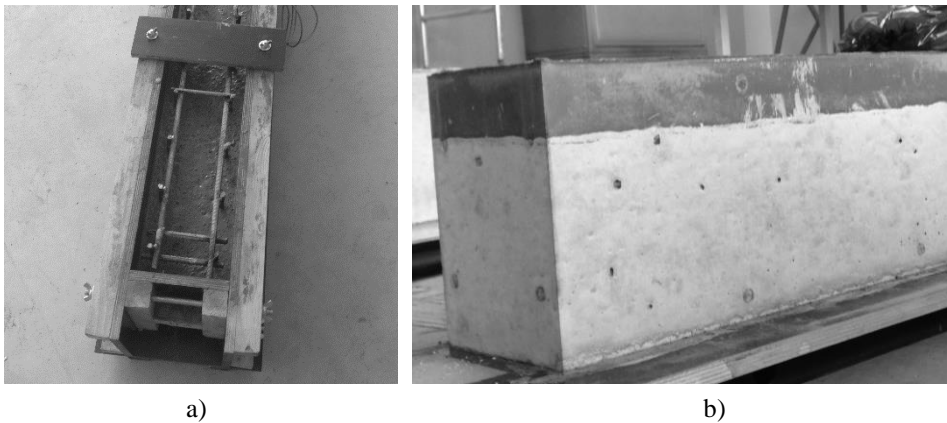
2.8 pav. Kompozitinių gelžbetoninių sijų betonavimas: a) pirmas kompozitinės gelžbetoninės sijos betonavimo etapas; b) kompozitinė gelžbetoninė sija nuėmus klojinius, betonavimo pozicijoje
