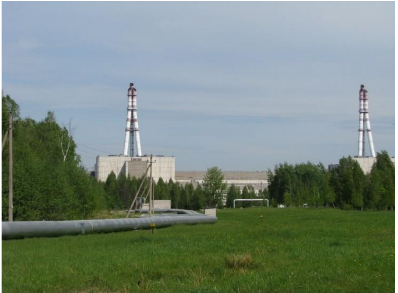
10 pav. Antžeminiu būdu pakloti šilumos tiekimo vamzdynai
