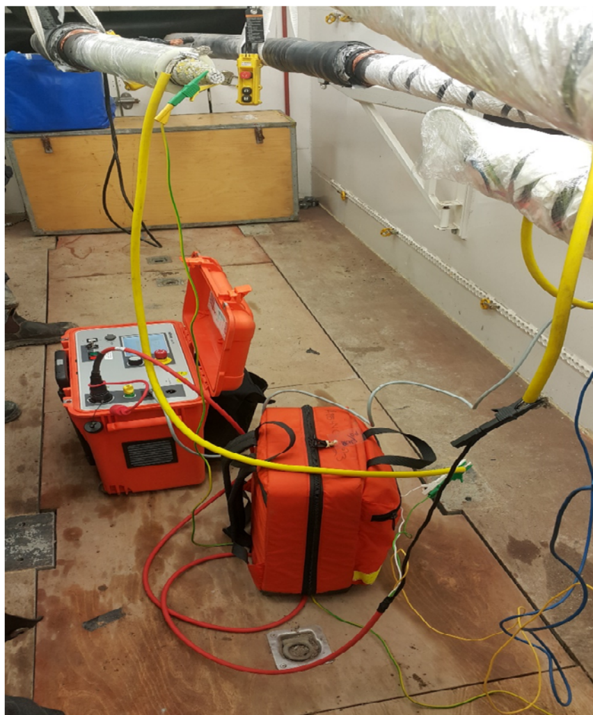
41 pav. Tiltelio metodu gedimo nustatymas ant atidalinto kabelio
