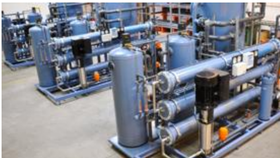
9 pav. Atbulinės osmozės įrenginių salė [15].
