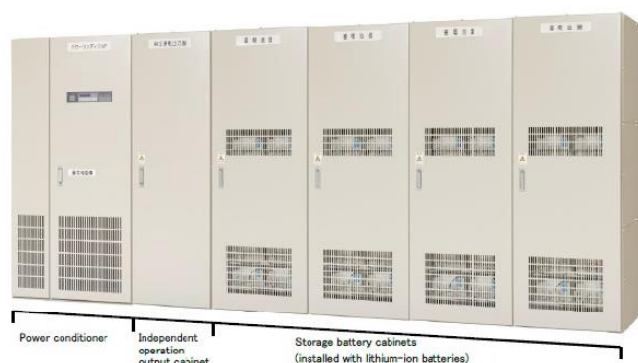
pav. 14 160 kW Li-ion baterija
