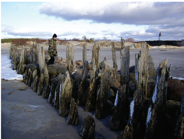
1 pav. Šventosios uosto molo liekanos Fig. 1. Remains of Šventoji port breakwater
