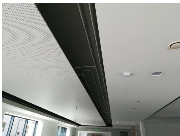
9 pav. Vėsinimo plokštės patalpoje
