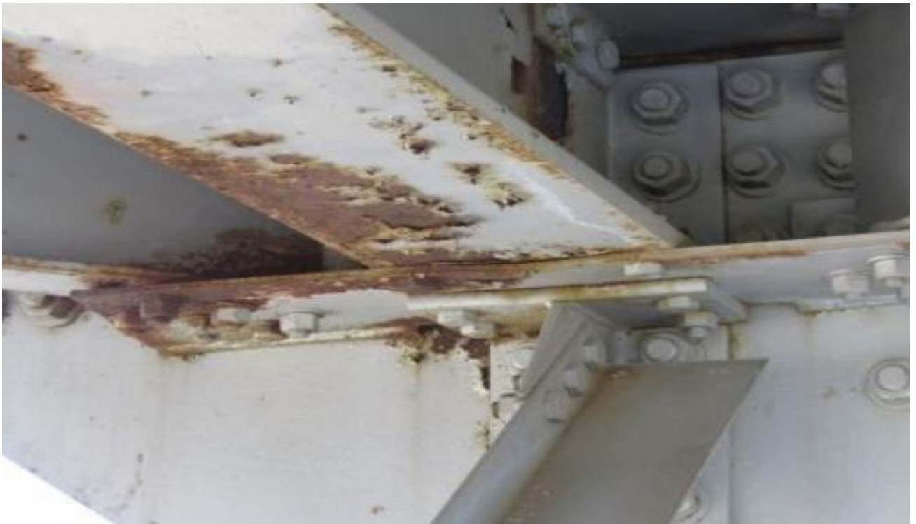
11 pav. Dažų, saugančių tilto konstrukcijas nuo korozijos, atsiskyrimas nuo plieno [25]
