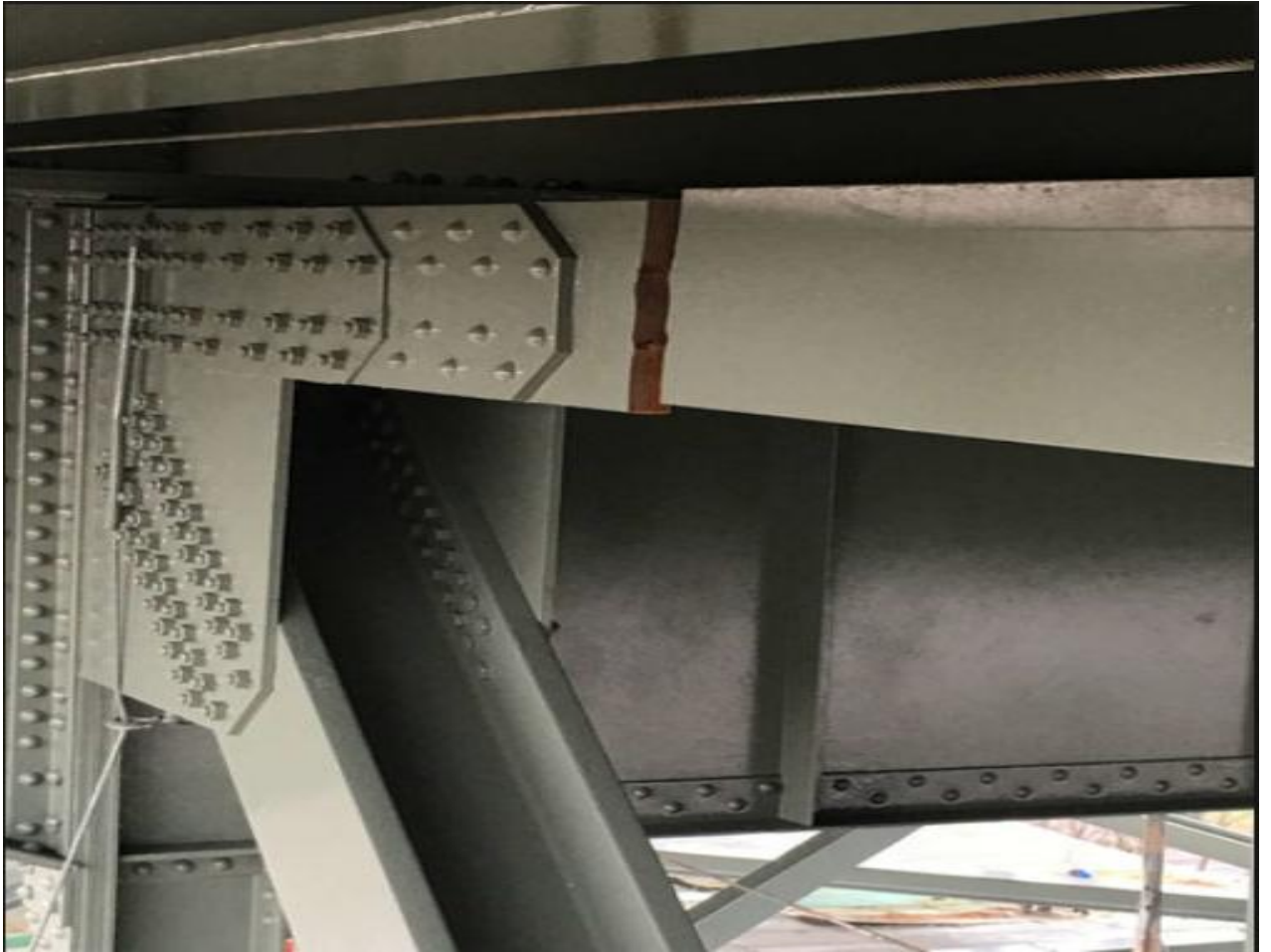
9 pav. Ryšio, tarp pagrindinių laikančiųjų sijų įtrūkimas. Delavero upės tiltas, JAV [23]
