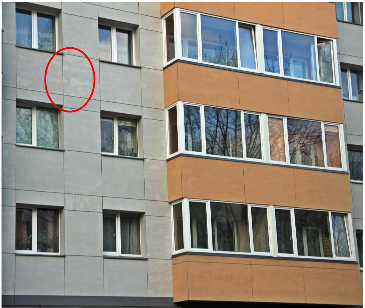
1.19. pav. Plokščių spalvos išblukimas [19].
