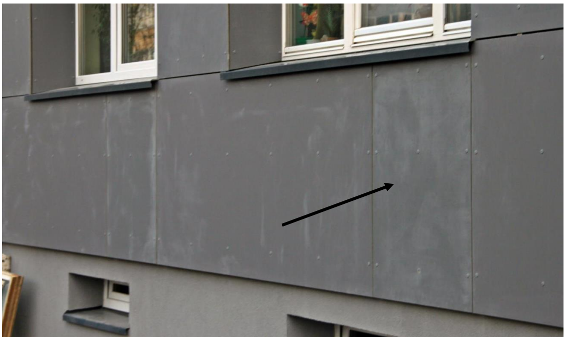
1.20. pav. Plokščių spalvos išblukimas [19].
