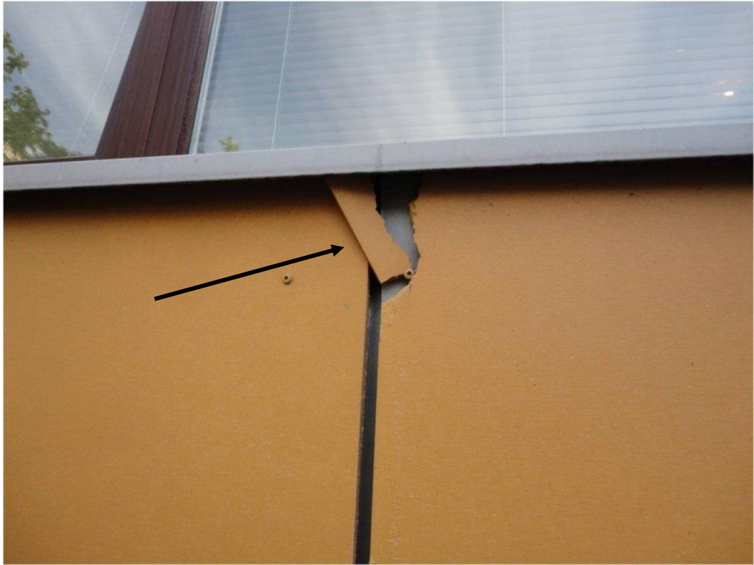
1.16. pav. Plokščių montavimo brokas [17].
