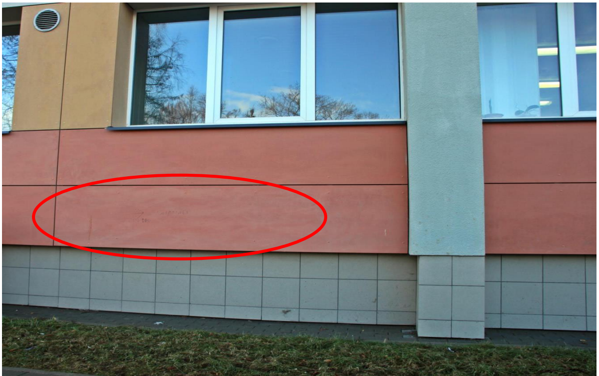
1.17. pav. Plokščių spalvos išblukimas [19].
