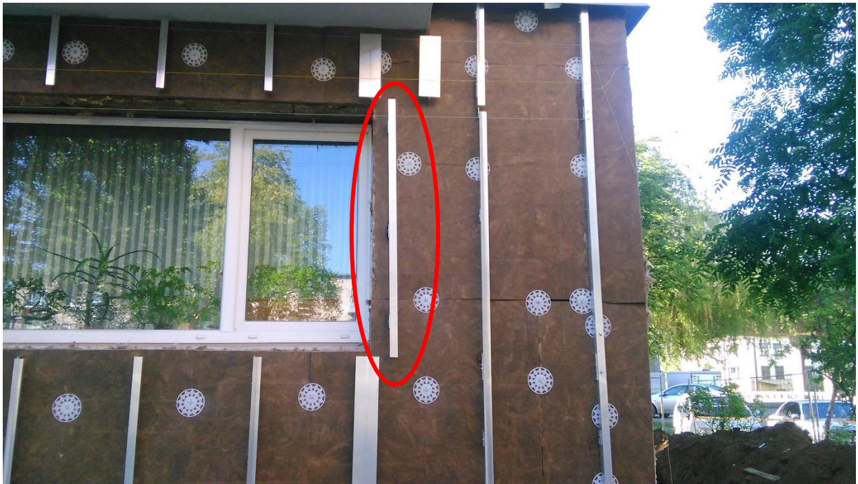
1.28. pav. Blogai įrengtas plokščiu laikantysis karkasas.
