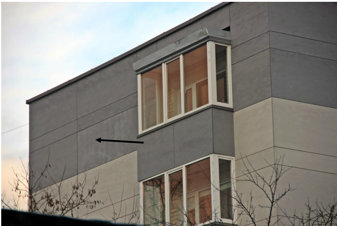
1.21. pav. Plokščių spalvos išblukimas [19].
