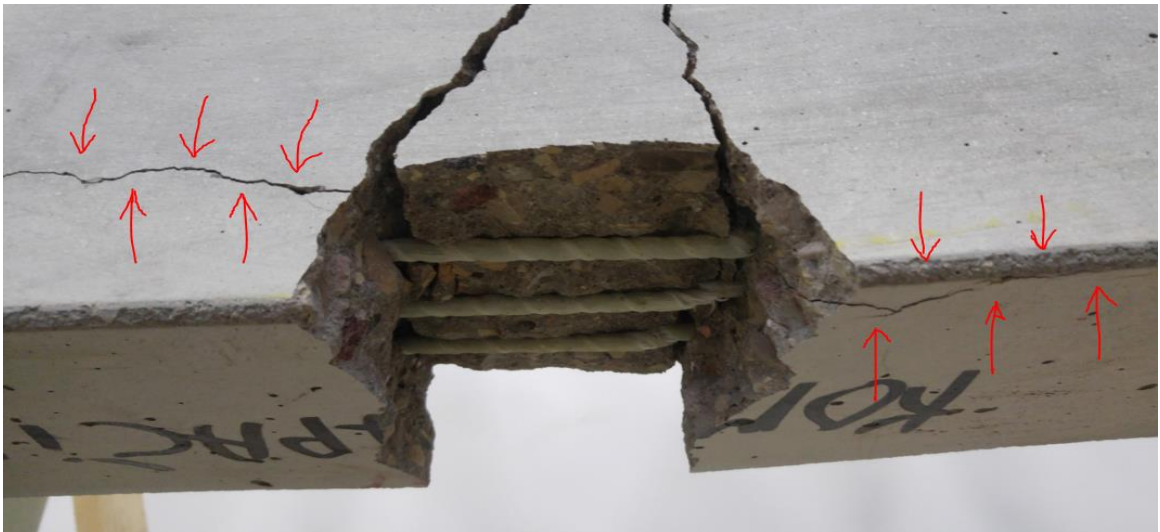
5.1.1. pav. Armatūros ir betono sukibimo praradimas. Išilginiai plyšiai armavimo linijoje.
