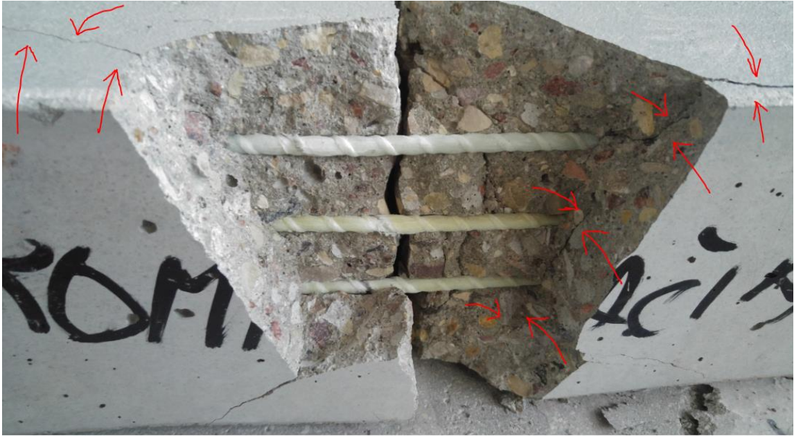
5.1.2. pav. Armatūros ir betono sukibimo praradimas. Išilginiai plyšiai armavimo linijoje.
