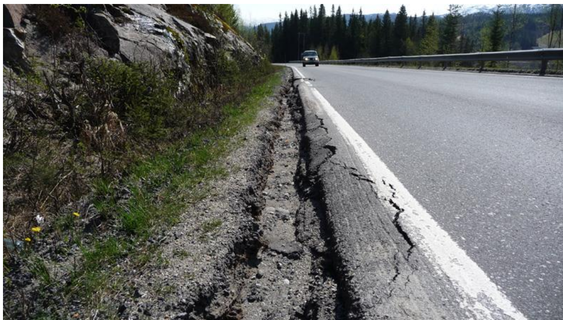
1.1 pav. Šalikelių erozija (6)
