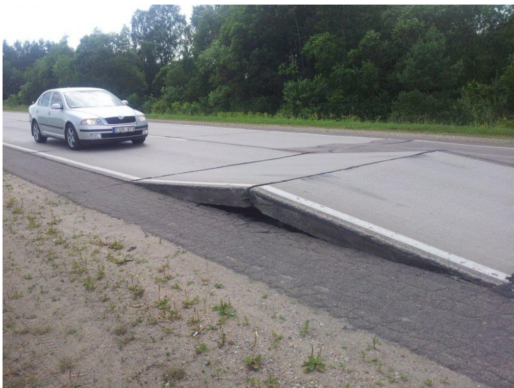
1.5 pav. A14 Vilnius–Utena kelio betoninės dangos deformacijos (24)
