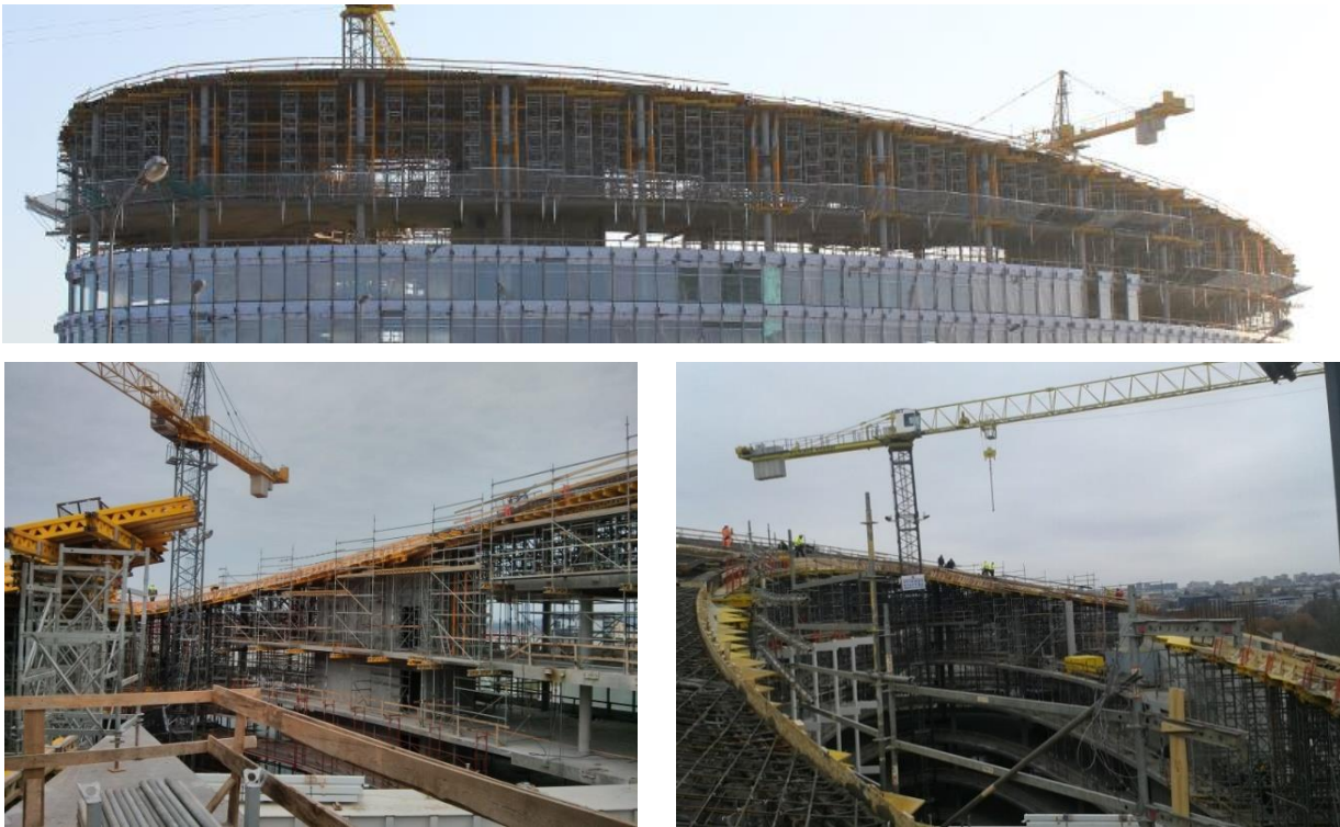
4 pav. Surenkamųjų skydinių klojinių panaudojimas administracinio pastato Vilniuje, Konstitucijos pr. 29 nuožulnios perdangos įrengimui
