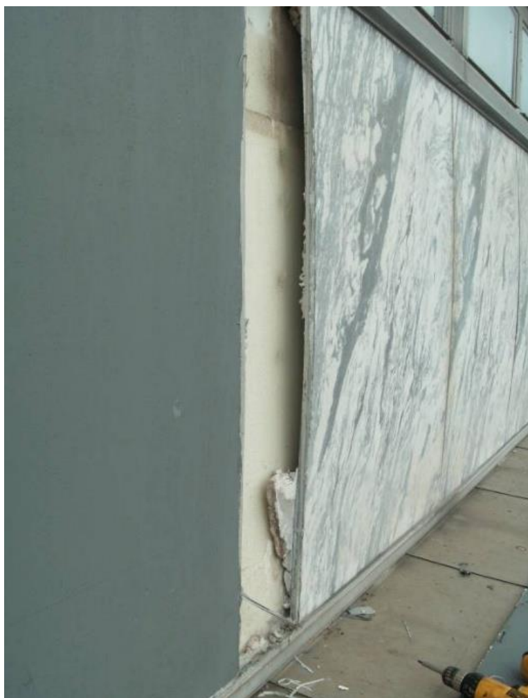
2.1 pav. Išlinkusi fasadinė akmenų plokštė (33)
