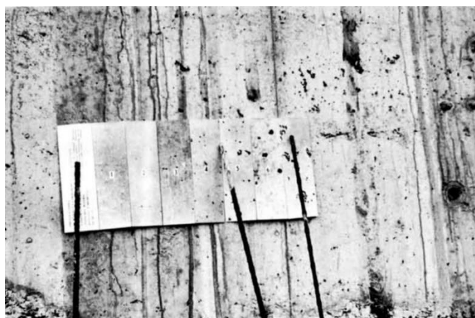
6.1.2.2. pav. Betono paviršiaus vertinimas pagal CIB skalę [21]
