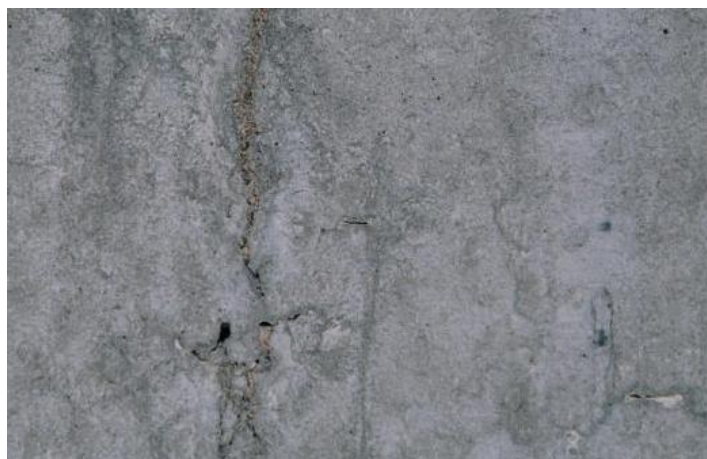
6.1.1.2. pav. Išplovų ruožai betono paviršiuje
