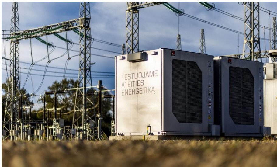
13 pav. Litgrid 1 MW baterijų energijos kaupimo sistema
