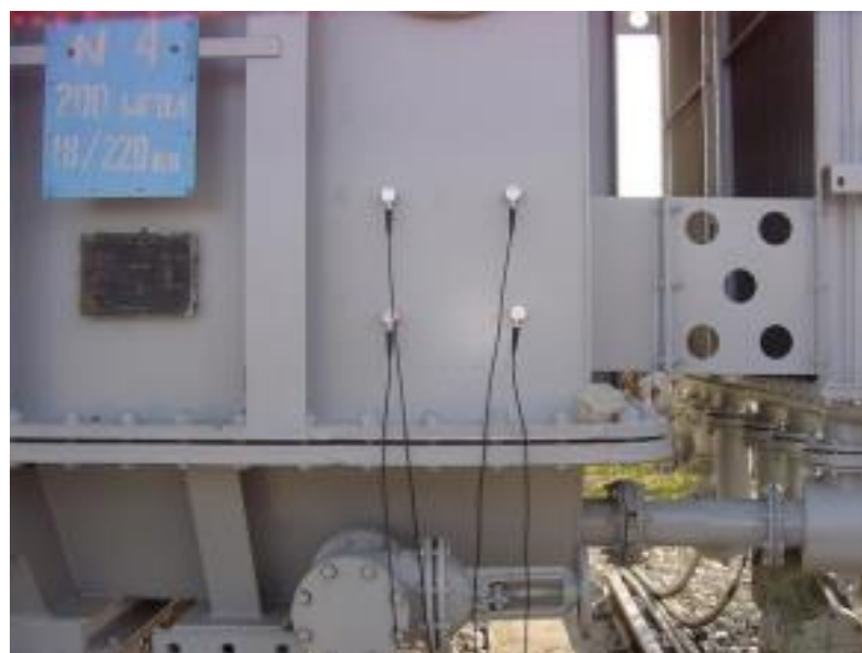
2.6. pav. Akustiniai sensoriai sumontuoti prie transformatoriaus sienos[6]
