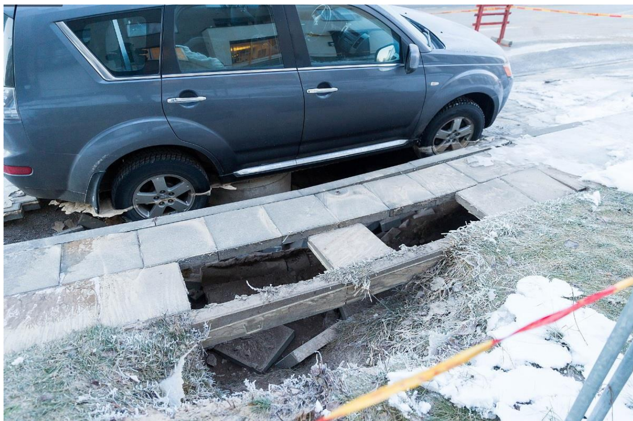
1.4 pav. 2017 metų pradžioje dėl šalčių trūkusios geriamo vandens linijos, padariniai, šaltinis – 15min.lt
