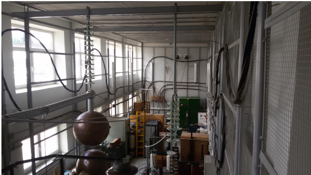
4.1 pav. Tiriamasis kabelis esantis KTU aukštos įtampos laboratorijoje
