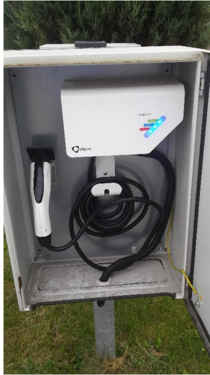
1.6 pav. Greitojo įkrovimo stotelė ir kabelis
