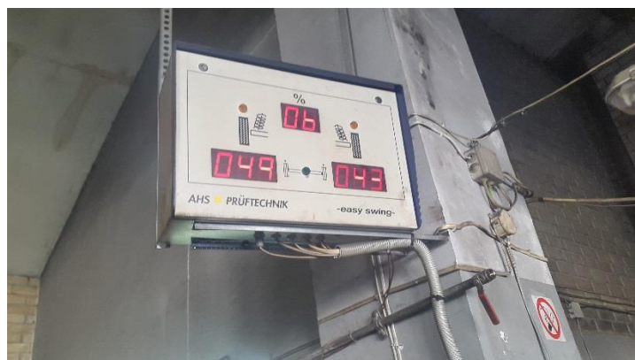
27 pav. Priekinės ašies virpesių slopintuvų būklė
