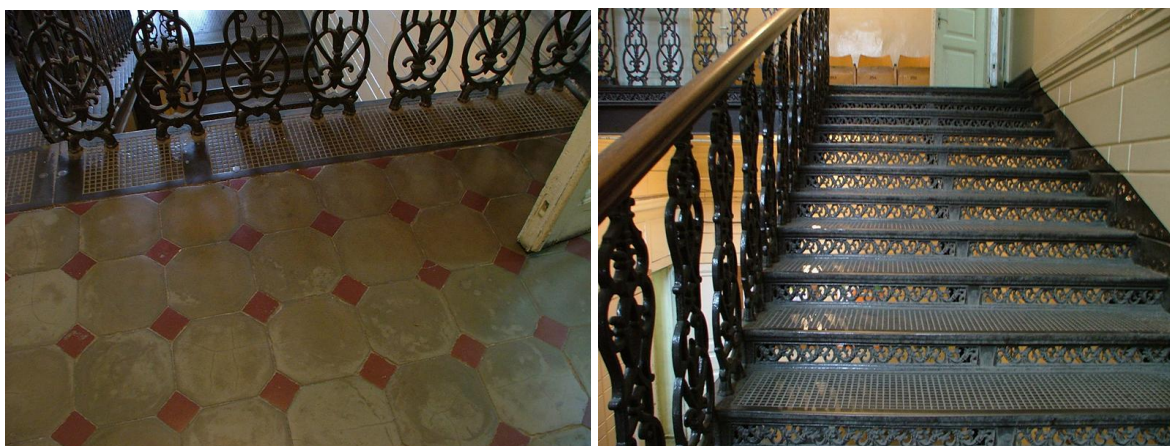
18 pav. Kauno tvirtovės administracinių pastatų komplekso karinio telegrafo stoties pastato išsaugoti autentiški elementai.
