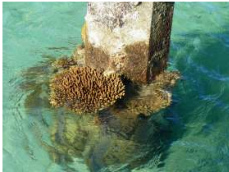
1.14 pav. Ant betono konstrukcijos augantis koralas
