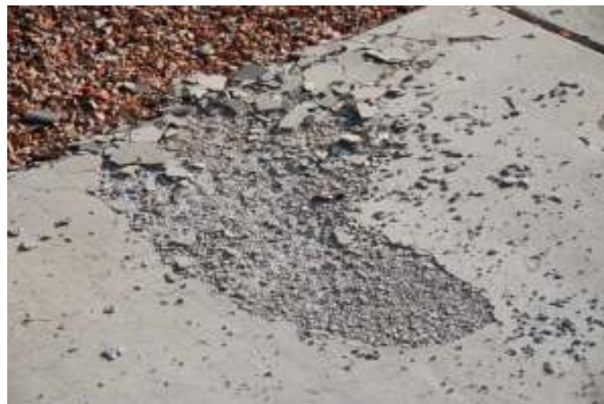
1.2 pav. Betono paviršiaus atsiluoksniavimas
