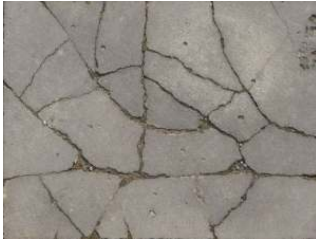
1.1 pav. Įtrūkimai betono paviršiuje
