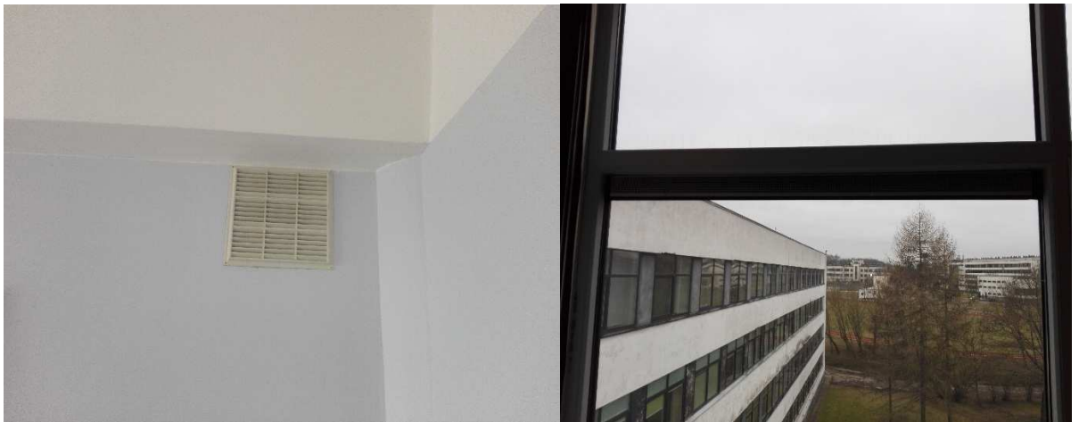
1 pav. Vėdinimo grotelės ir orlaidės auditorijose
