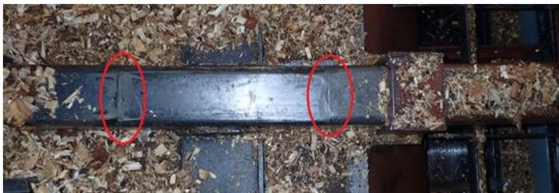
5.2 pav. Vamzdžio išorės metalas įtrūkęs per abi siūles
