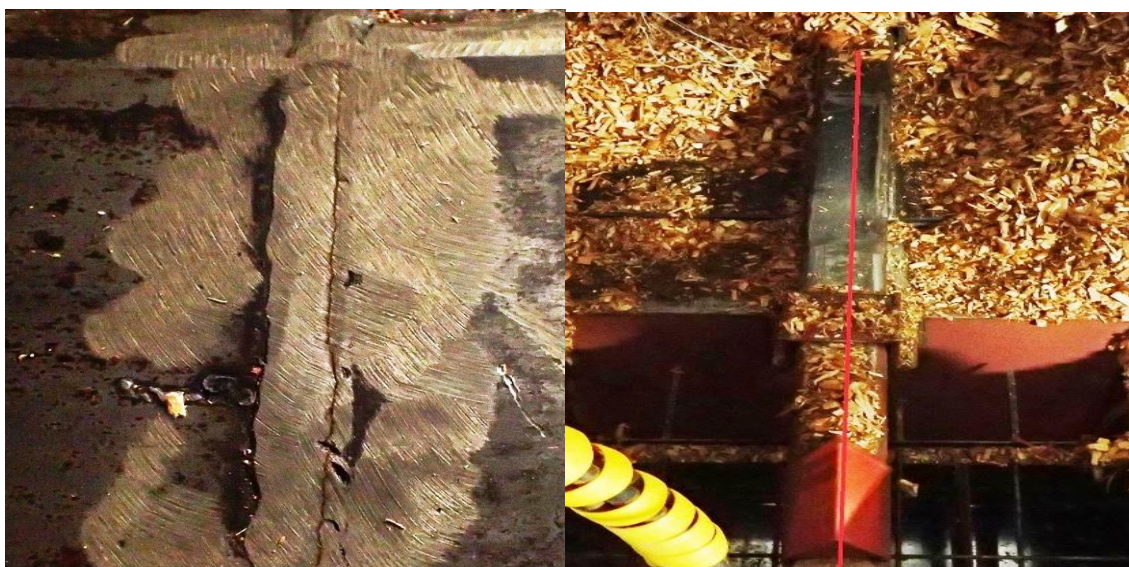
5.3 pav. Siūlės įtrūkimas ir žertuvo platformos sulinkimo vieta
