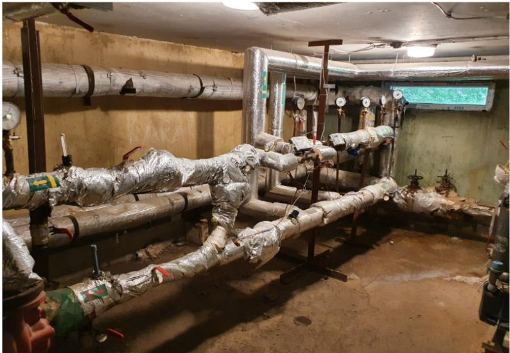
13 pav. Analizuojamo objekto šilumos punktas. Šaltinis autoriaus, 2022.
