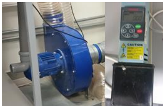
2.4 pav. Ventilatorius ir jo valdiklis
