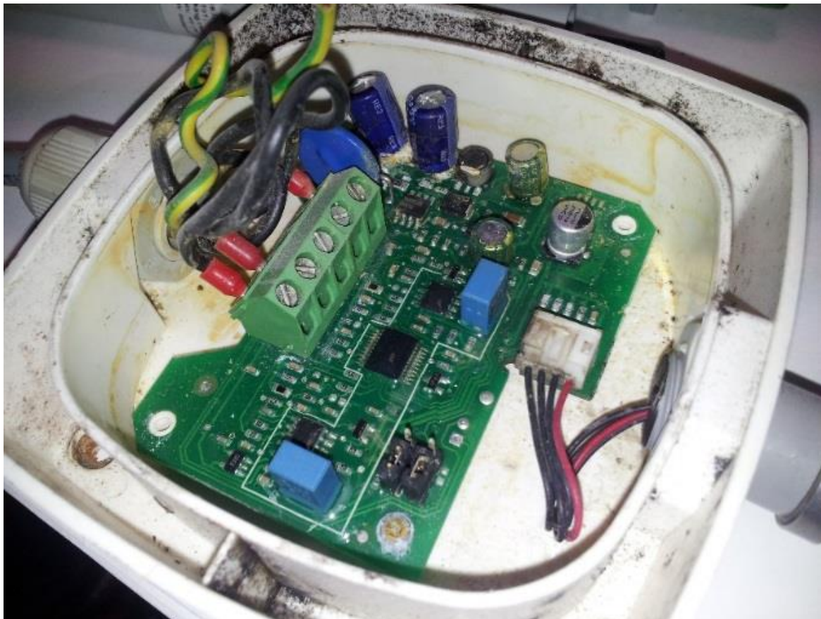
3.3 pav. Santykinės drėgmės matavimo jutiklis „Carel DPDC210“ paveiktas drėgmės
